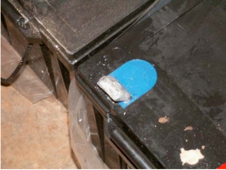
شكل 7.2: بطارية حمضية باستطاعة 200 أمبير. يظهر قطب البطارية السالب وقد انكسر أثناء النقل.
